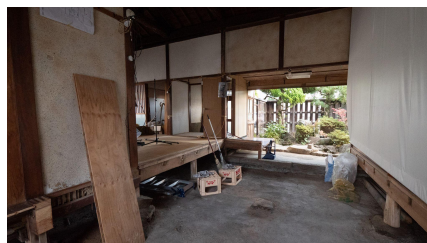
解体／改修で床を抜いて表と裏の庭をつなぐ通り土間となった客間
